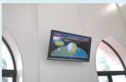
【発電状況表示ディスプレイ】 中央教育研究棟 1階 エレベータホール設置
