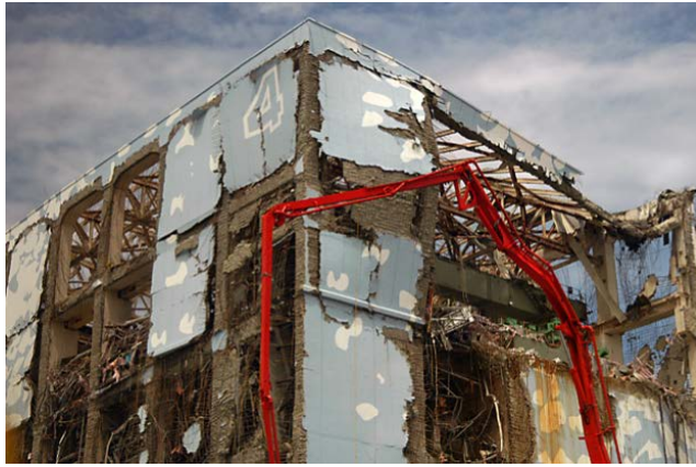
図 3.4 爆発で外壁の吹き飛んだ福島第一原子力発電所 4号機の様子（写真は IAEA (fact finding team) による）。
